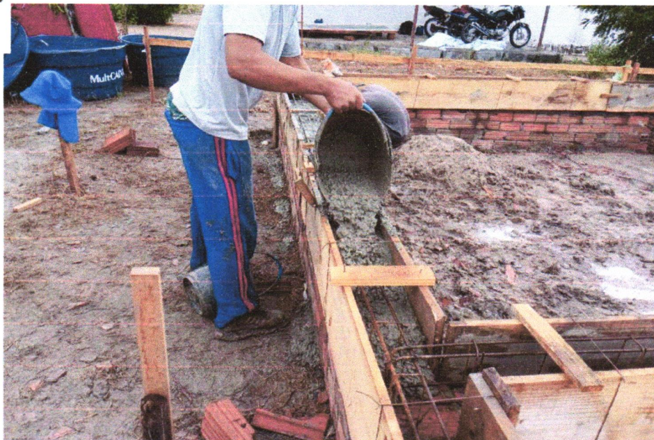
Foto 12 - COMPOSIÇÃO REPRESENTATIVA) EXECUÇÃO DE ESTRUTURAS DE CONCRETO ARMADO, PARA EDIFICAÇÃO HABITACIONAL UNIFAMILIAR TÉRREA (CASA EM EMPREENHIMENTOS), FCK = 25 MPA. AF_01/2017
